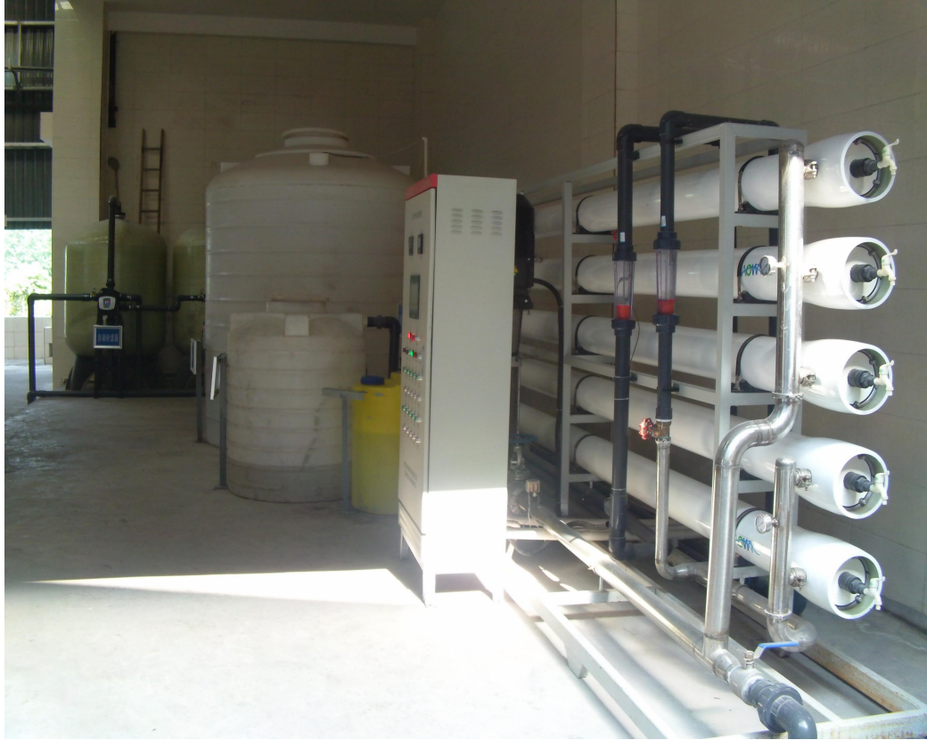
图 3-3 超滤反渗透系统照片
