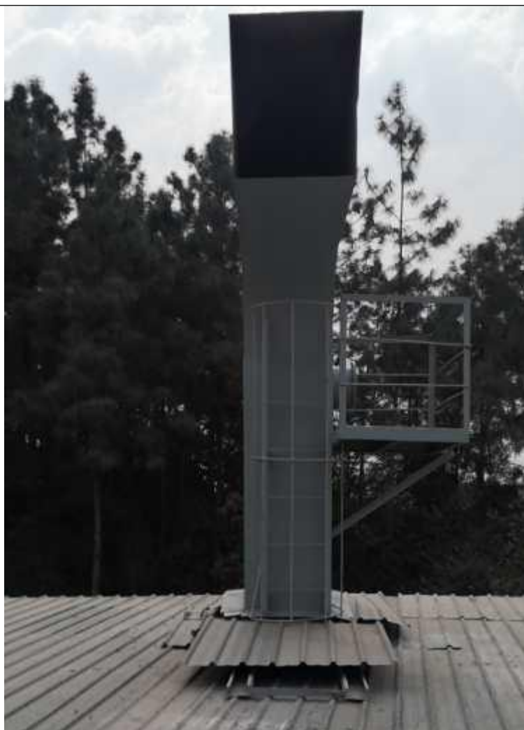
图 3-5 布袋除尘器排放口照片
