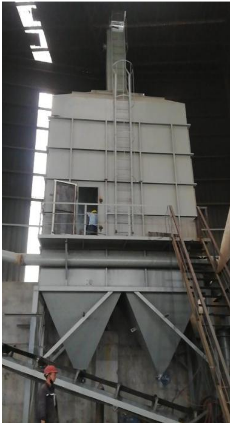
图 3-4 布袋除尘器照片
