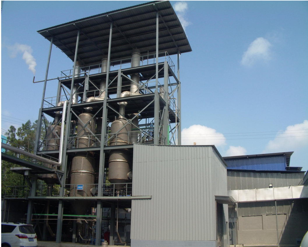
图 3-1 三效蒸发系统照片
