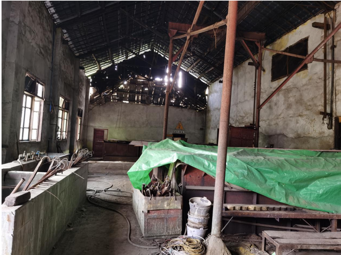
镀铬车间遗留镀槽
