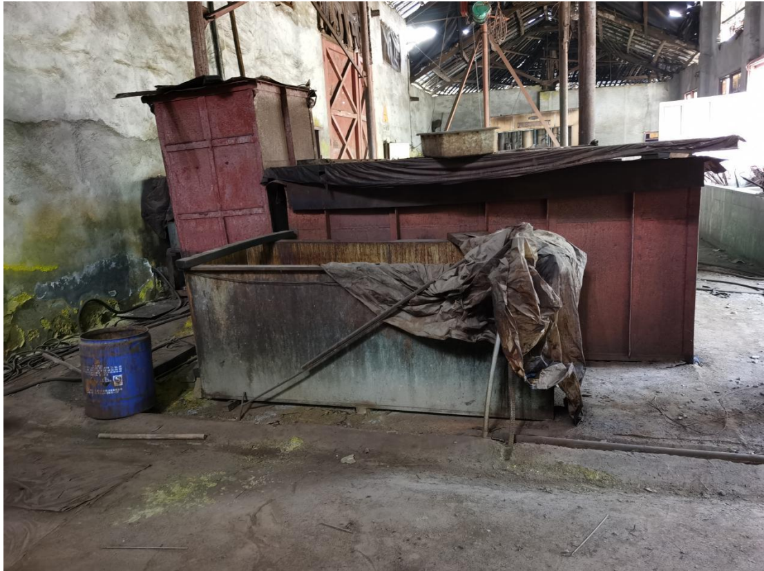
镀槽区域地面及墙面腐蚀现状
