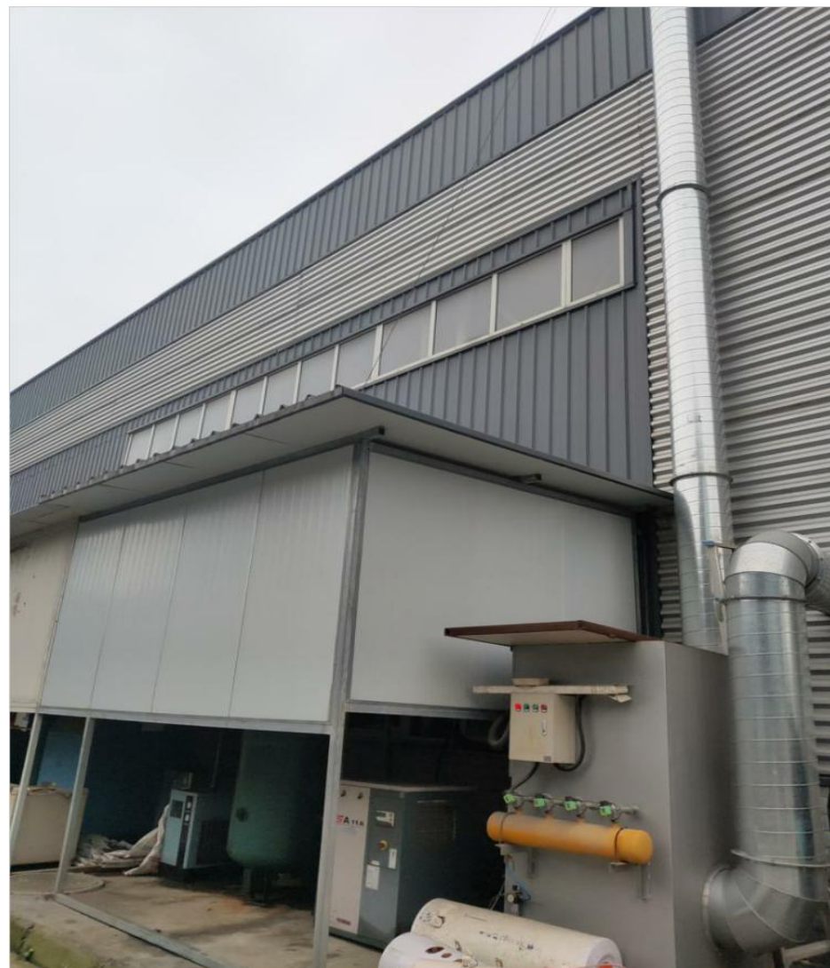
粉碎废气处理设备
