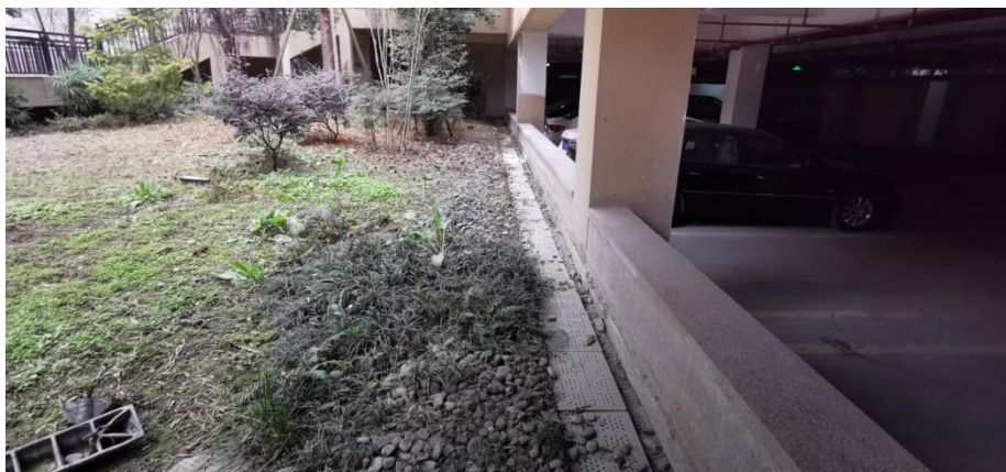
建筑周边盖板沟
