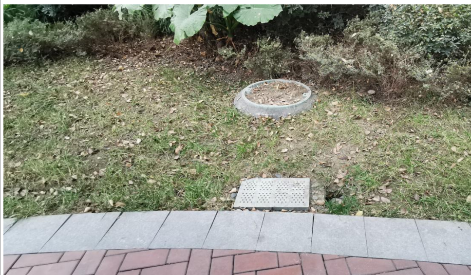
雨水井、雨水口
